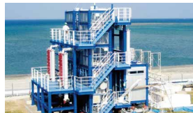
久米島100kW海洋温度差発電実証プラント
