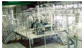
30kW海洋温度差発電装置
