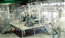
30kW海洋温度差発電装置
